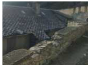
Couvertines disparues créant une entrée d'eau dans le mur
