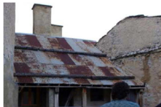
Toiture tôle inadaptée, à vérifier et remplacer à terme
