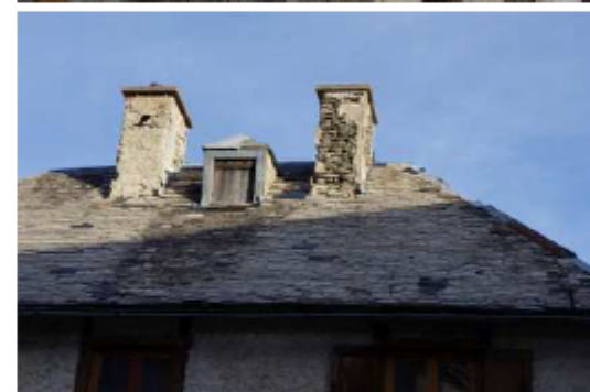
Toiture très dégradée présentant un risque pour la sécurité des visiteurs et la préservation du bâtiment
