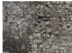
Parement déstructuré avec éboulement, mur de la casemate nord, suite à défaillance couvertine
