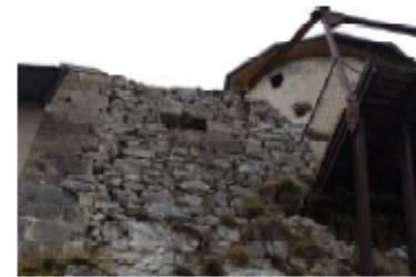
Fissure importante dans le rempart de l'enceinte côté sapine (risque d'éboulement)
