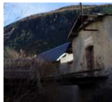
Pont-levis très dégradé à sécuriser
