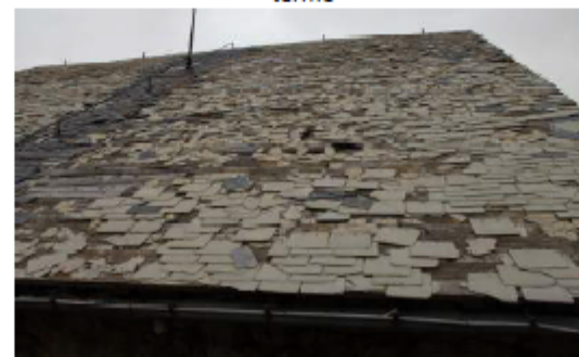
Toiture de la poudrière très dégradée, mise hors d'eau non assurée
