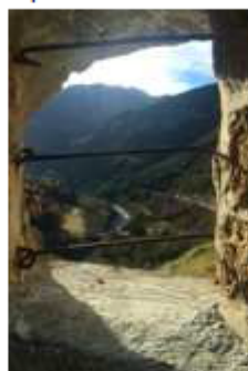
Meurtrière à sécuriser
