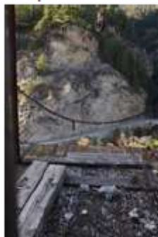
Sapine dégradée à sécuriser
