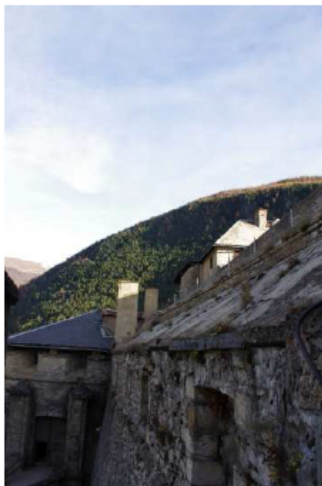
Glacis très dégradé, étanchéité à reprendre
